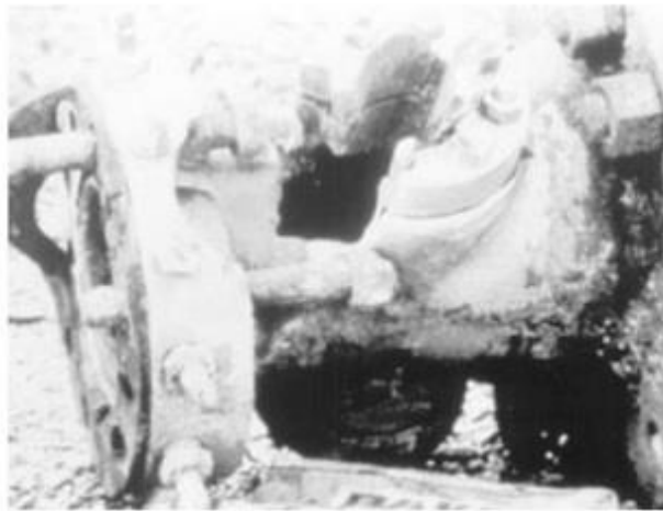
Slika 4.4. Oštećenje ventila usled erozije
