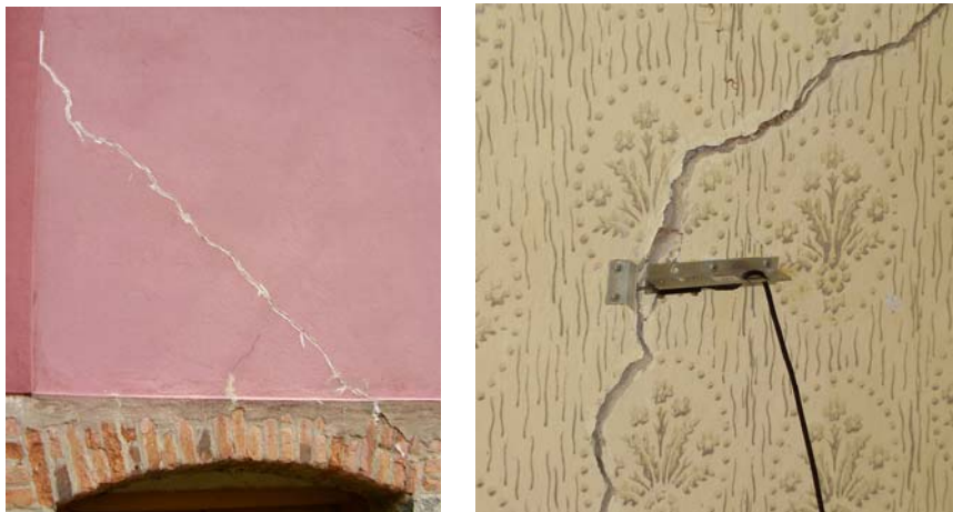
Slika 4-34. Pukotina 2 sa spoljne strane kuće (levo) i položaj senzora na pukotini 2 (desno)
